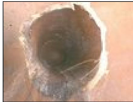
Beispiel für Schadensbild Riss (Stadtentw. Braunschweig)
